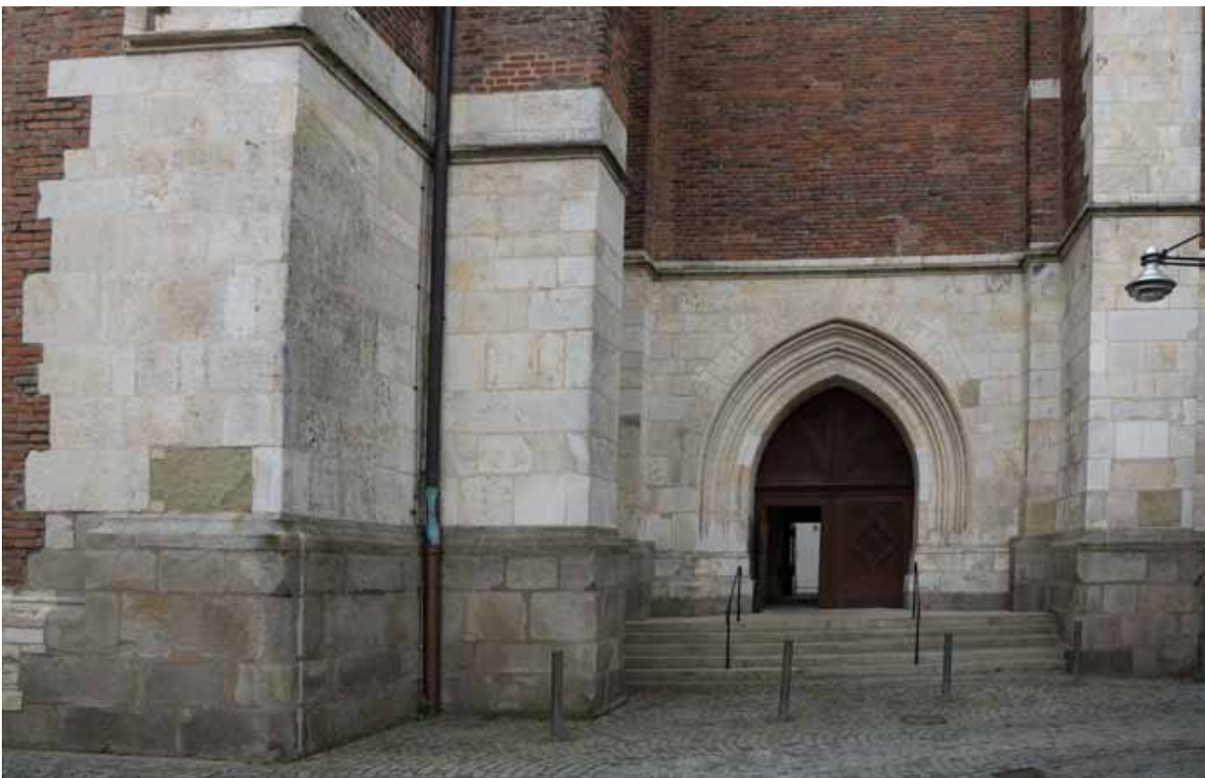
▲ Abb. 1. Die Basilika St. Jakob ist eines der beeindruckendsten Ziegelbauwerke Straubings. Der Sockel des Turms besteht aus Mettener Granit, die Eckmauerungen aus Oberjura-Kalksteinen mit einzelnen Blöcken von Regensburger Grünsandstein.
