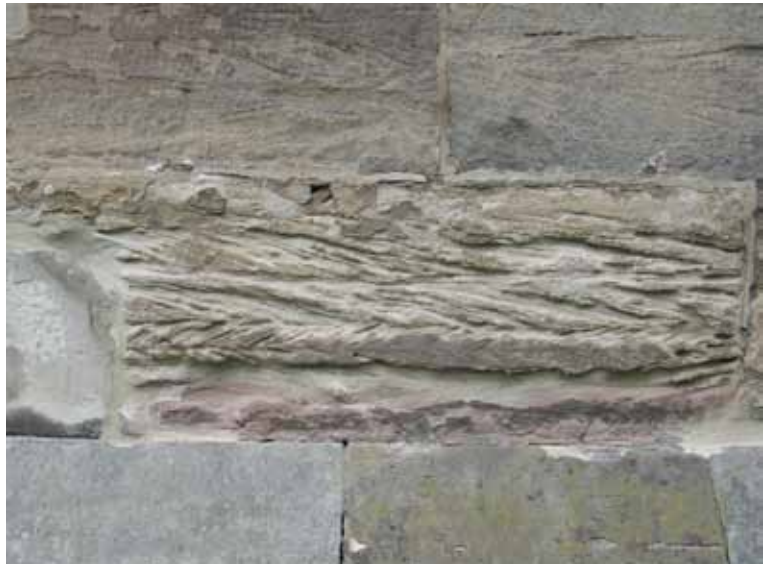
▲ Abb. 14. Die dolomitisch gebundenen Sandsteine der Bernburg-Formation zeigen bei Feuchtigkeitseinfluss starke Verwitterungsanzeichen (Absanden), durch die die Sedimentstrukturen herausgearbeitet werden.
